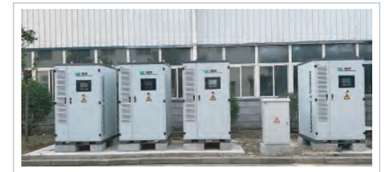
Henan Zhumadian CIMC Huajun Automobile Co., Ltd. 2.8MWh Project
