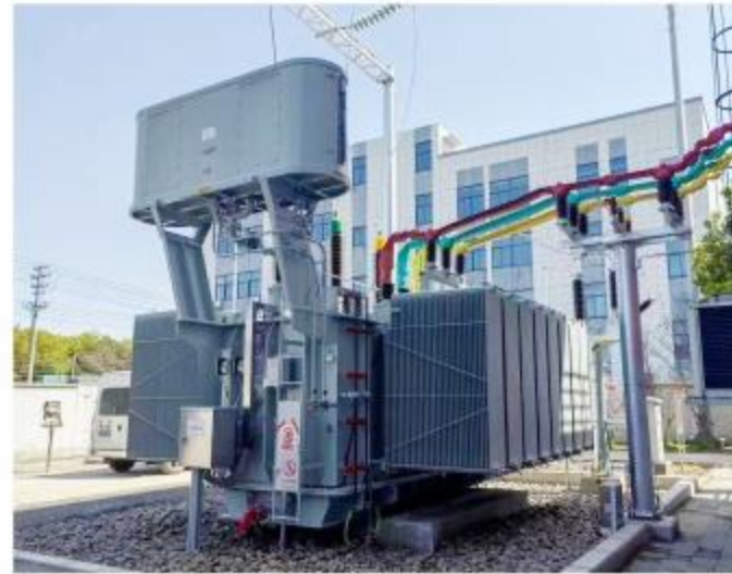
国网浙江南林110KV变电站项目 State Grid Zhejiang Nanlin 110KV Substation Project
